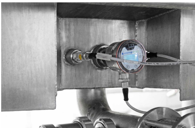
Pratique courante pour les réservoirs de stockage et de maturation : installation simple d'un capteur de niveau hydrostatique (ici L3 Neo), d'un capteur de température et d'un détecteur de niveau sur la partie inférieure du réservoir
