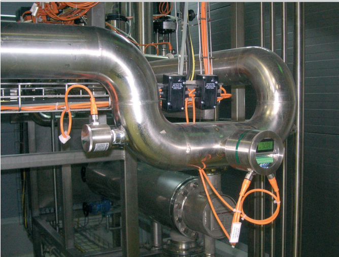
Séparation de phases dans une installation de NEP avec ILM-2
