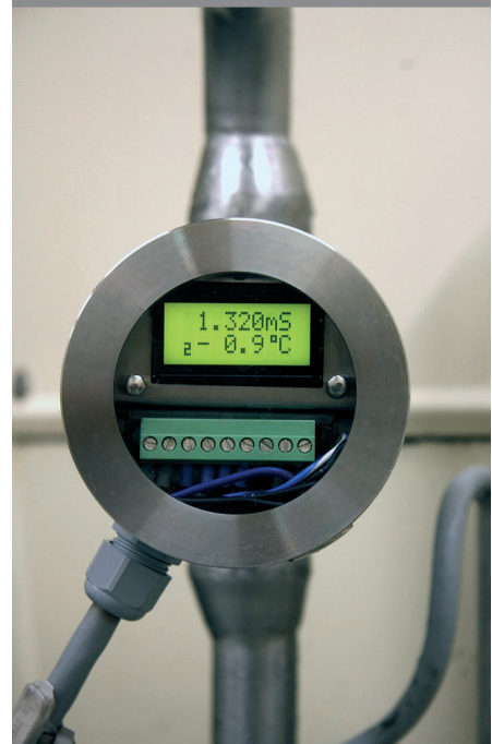
Abb. 2: Kontinuierliche Leitfähigkeitsmessung am Reaktionstank mit induktivem Leitwertmesser ILM-2 von NEGELE
